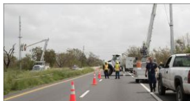
Esperan corregir esta semana las fallas en conexión de energía del sur al norte
